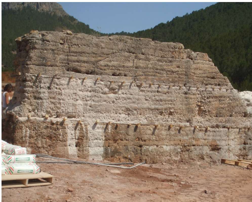
Fig. 6.- Frente exterior del muro Noroeste con los cortes horizontales, junio de 2007 (Fuente: Sánchez Medrano, Fco. J.)
